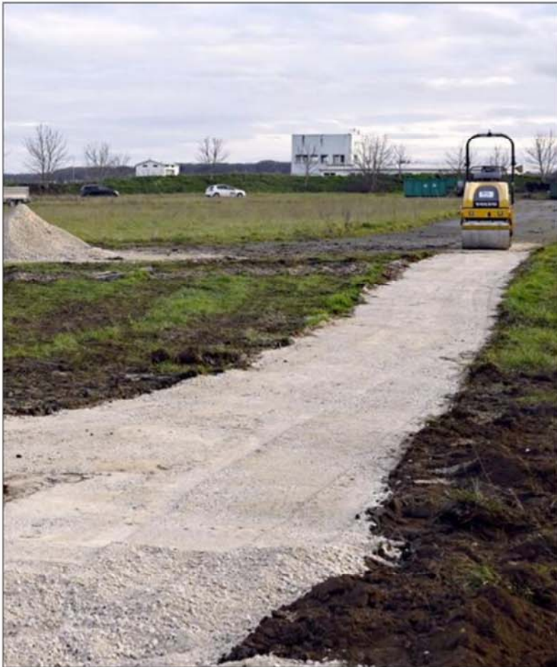
Une piste de 1 000 m, à deux pas de l'aéroport de Nancy/Essey, est en construction depuis le 16 décembre. Photo ER/Cédric JACQUOT
