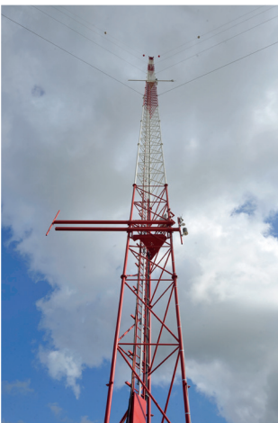
Station atmosphérique de l'Observatoire pérenne de l'environnement
